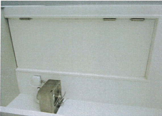
Fot. 38. ROZDZIELNIA KELNERSKA POZIOM P0, pomieszczenie a.p 0.2.04
