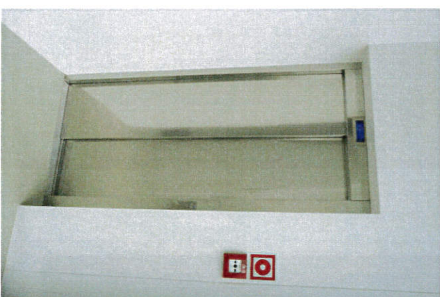
Fot. 39. ROZDZIELNIA KELNERSKA POZIOM P0, pomieszczenie a.p 0.2.04
