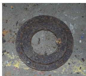
Fot.26 Pokrywa lewej oprawy łożyska
