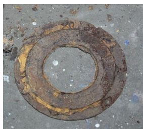
Fot.25 Pokrywa prawej oprawy łożyska
