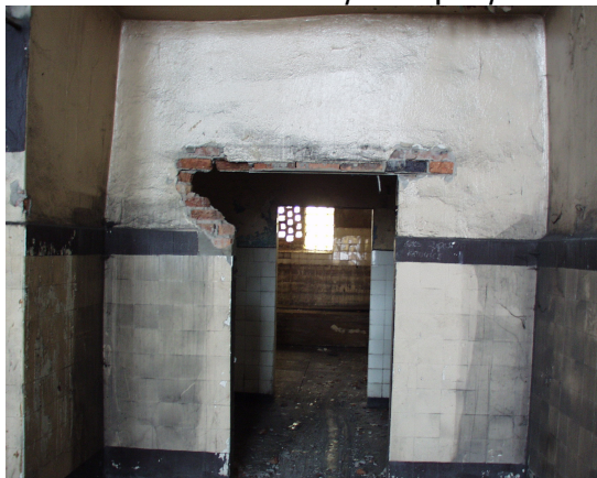
Fot. 7 Widok zdewastowanych nadproży w ściankach działowych.
