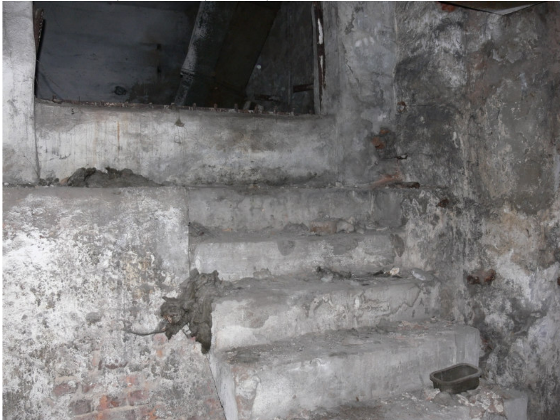
Fot. Ob-32/35 Obecny stan techniczny konstrukcji schodów.
