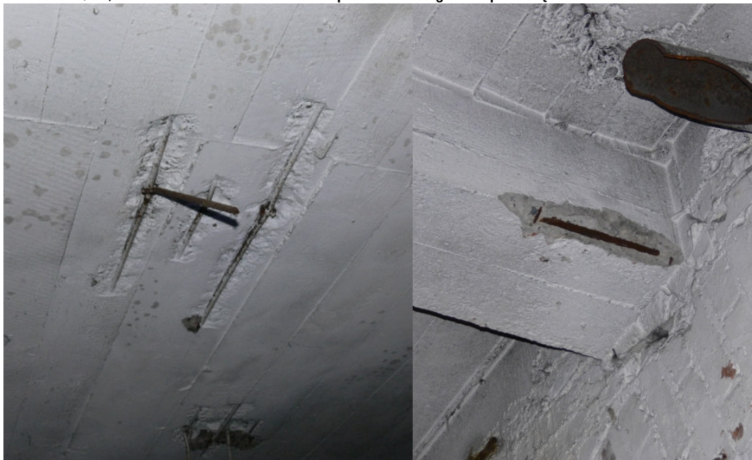
Fot. Ob-32/31,32 Widoczne uszkodzenia stropu żelbetowego nad piwnicą.
