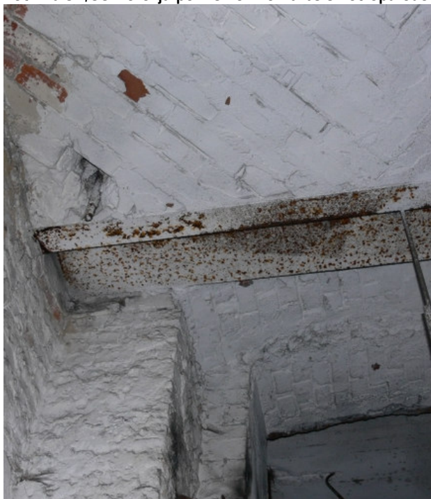
Fot. Ob-32/33 Korozja powierzchniowa belek stropu odcinkowego nad piwnicą.
