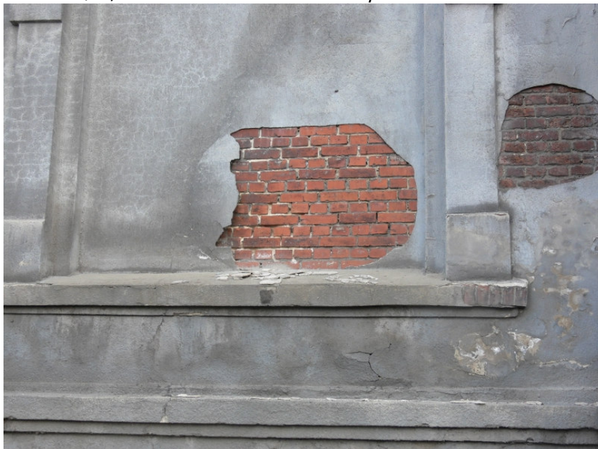
Fot. Ob-32/26,27 Widoczne liczne uszkodzenia tynku.
