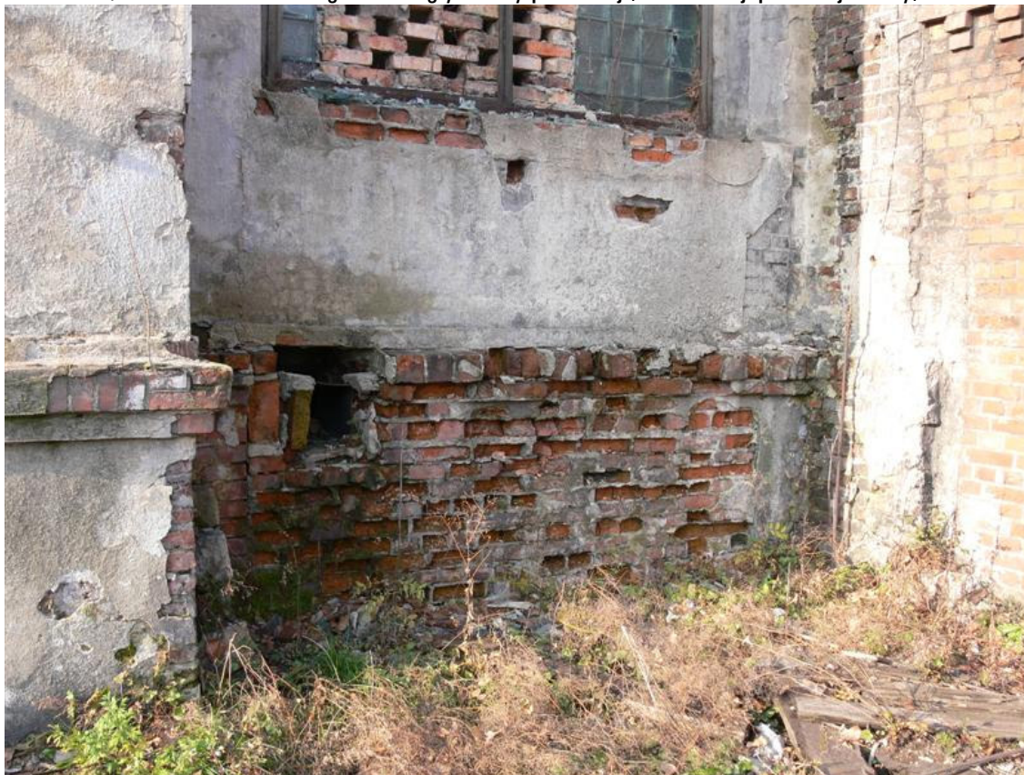
Fot. Ob-32/25 Złasowane i zawilgocone cegły ściany podłużnej (brak izolacji poziomej ściany).
