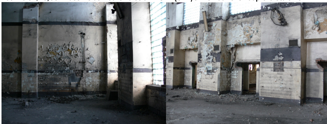
Fot. Ob-32/29,30 Widoczne uszkodzenia ścian wewnętrznych i skradzione nadproża stalowe.
