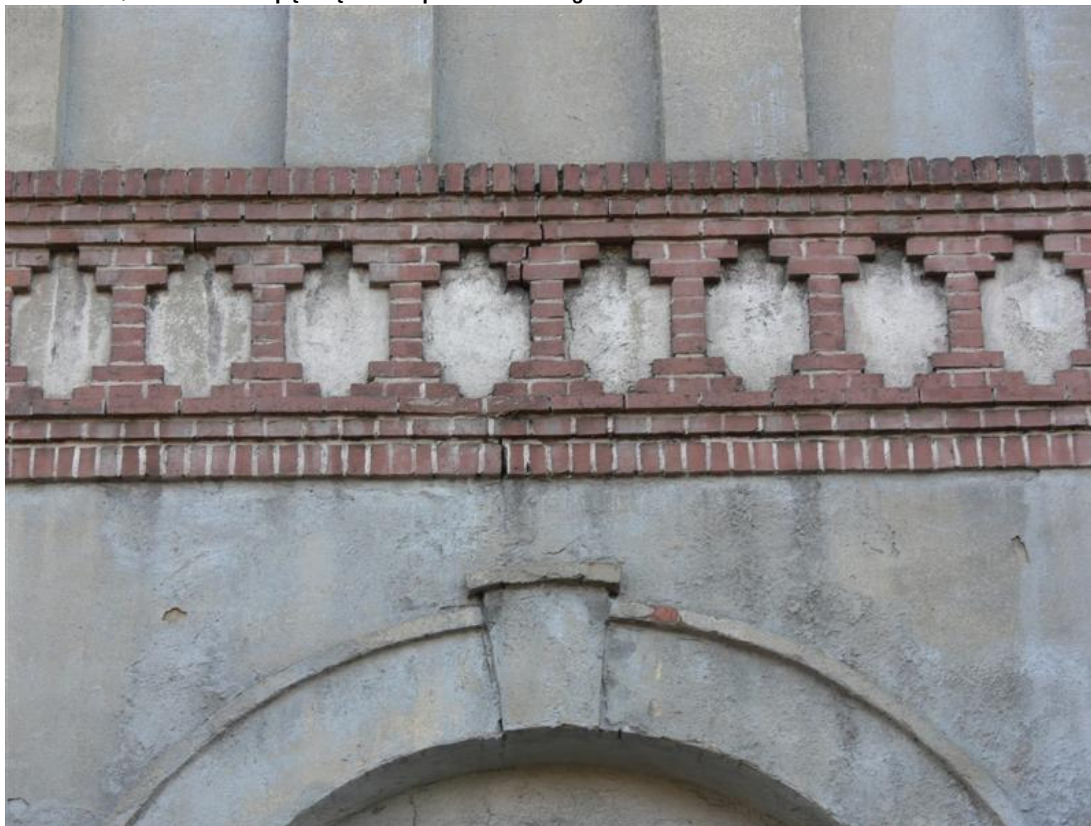
Fot. Ob-32/28 Widoczne pęknięcie nadproża okiennego.
