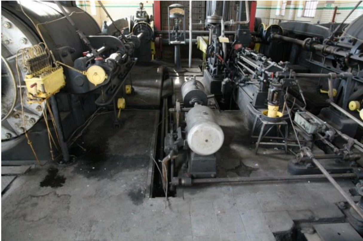
FOT.5 Brak pokryw kanałów i obramowań
