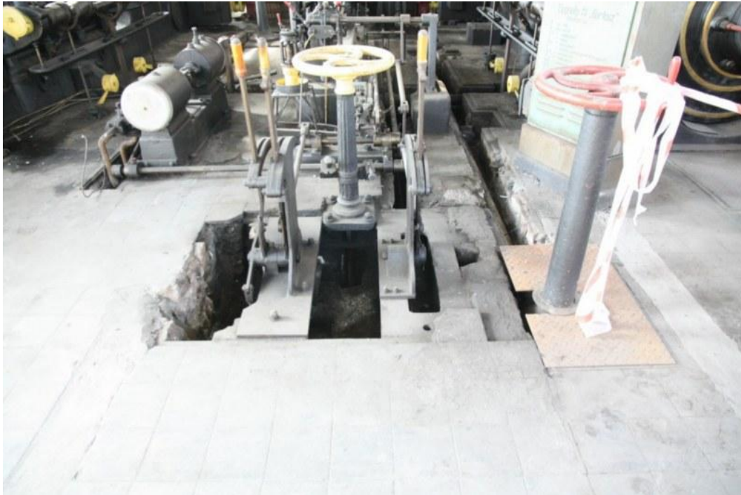
FOT.4 Brak pokryw kanałów i obramowań
