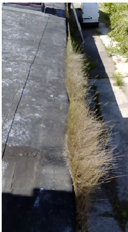
Fot. 16. Zabrudzona rynna od strony północnej.
